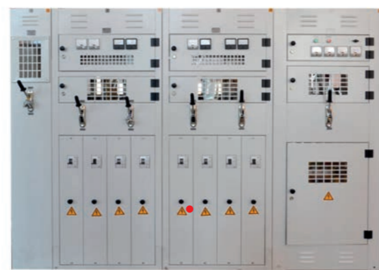
ПАНЕЛИ РАСПРЕДЕЛИТЕЛЬНЫХ ЩИТОВ ЩО-70-3
